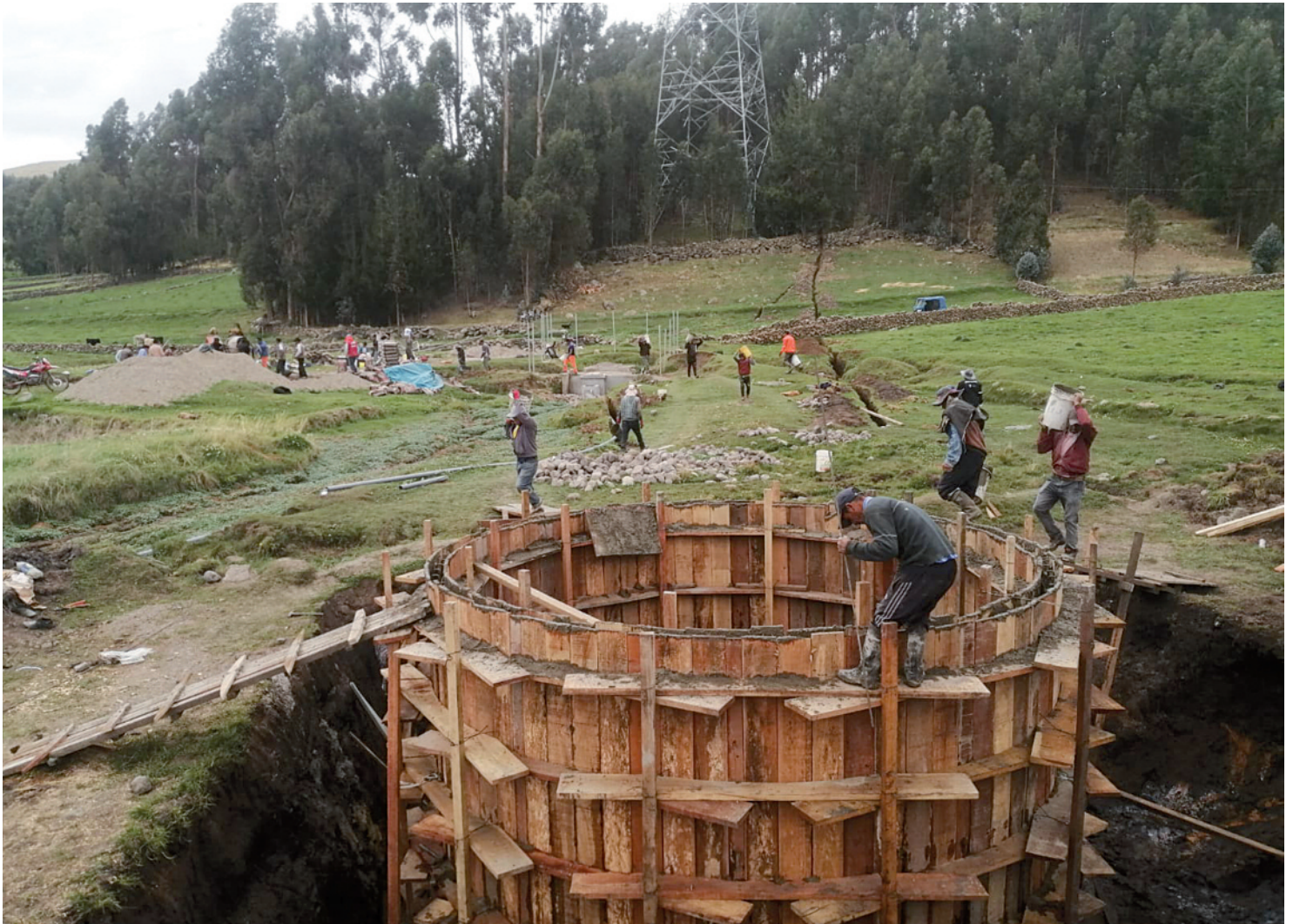
Sous la direction technique des Ailes de l'espérance, les habitants construisent le réservoir du système d'eau
